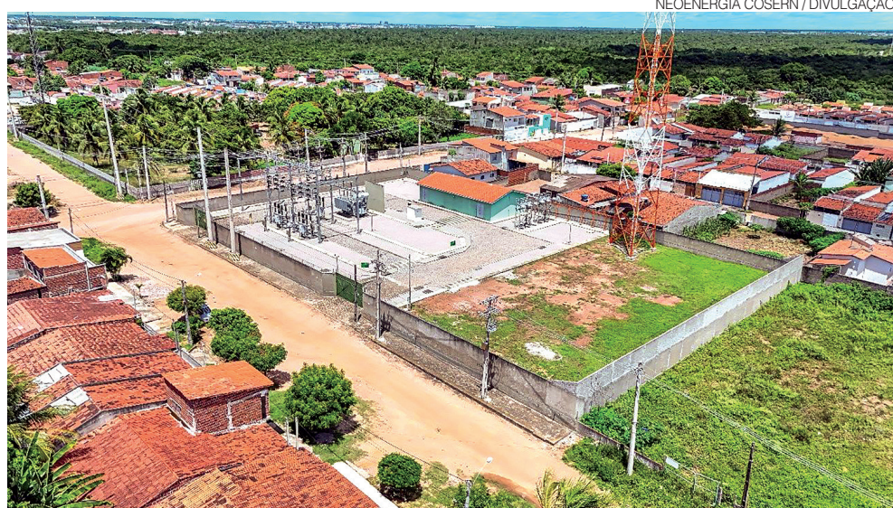
Subestação Elétrica Planalto: ampliação para acompanhar o crescimento urbano da capital potiguar
