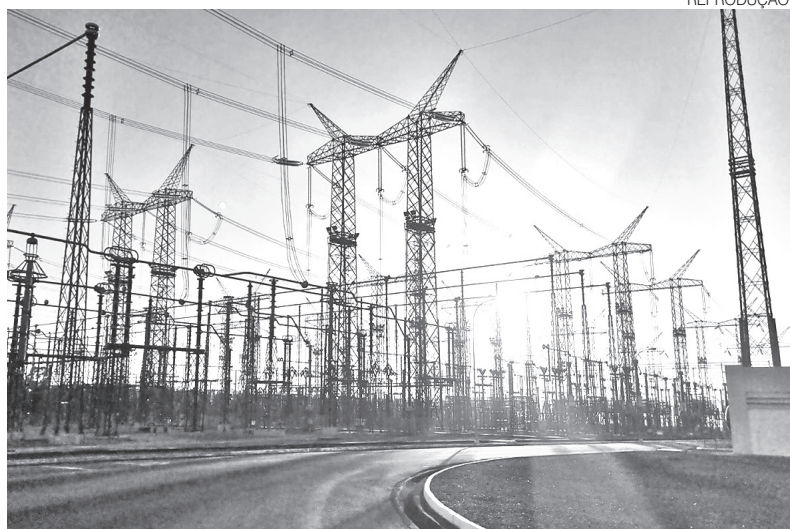
Projeto contempla instalação de equipamentos de alta tensão em duas estruturas
