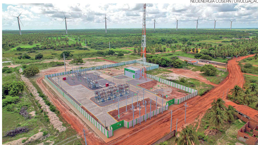
Até 2030, a distribuidora vai construir 10 novas subestações e ampliar outras 17 já existentes
