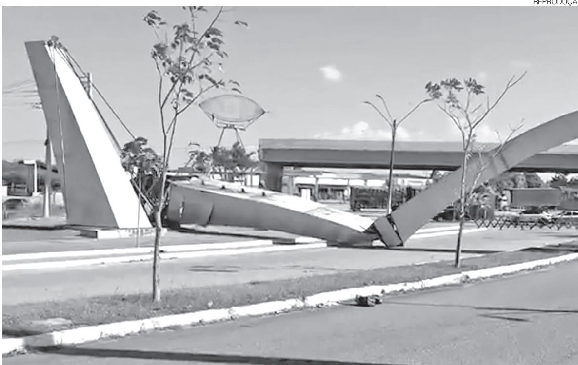
Parte central da estrutura metálica caiu sobre a avenida, que faz a ligação entre a BR-304 e o Centro de Macaíba
